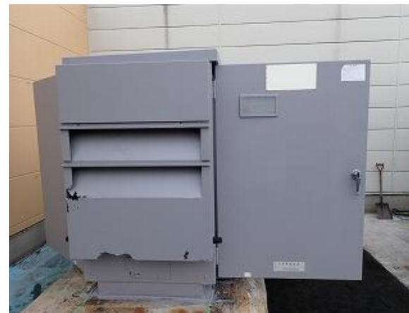
更に“重防食処置”(NETIS 推奨工法)
